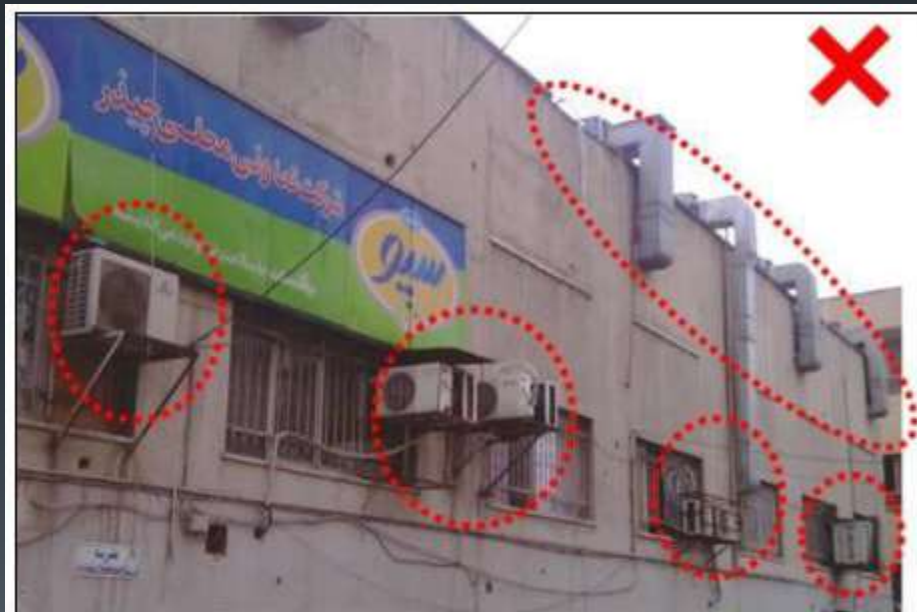
قابل رویت بودن تأسیسات از معبر عمومی و الحاق تجهیزات سرمایشی به طور نامناسب بر سطح نمای ساختمان
